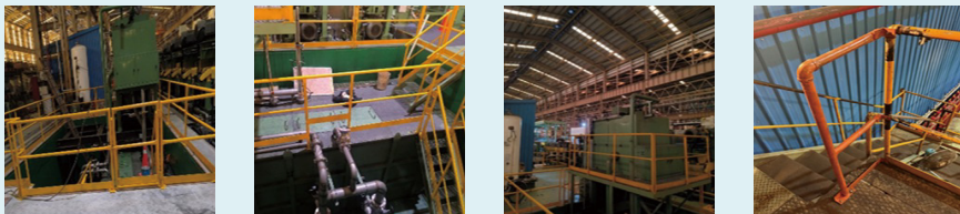
作業現場護欄裝置
