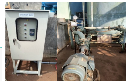
公用純水補充泵浦，加裝變頻器
